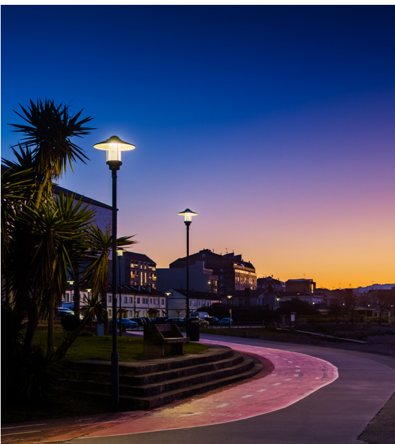
Conjuntos de alumbrado ATP Iluminación en Cangas de Morrazo (Galicia, España), compuestos por columnas inmunes a la corrosión y luminarias poliméricas Alfa.
